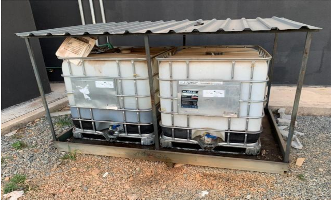
Figura 7 — Tanques reservatórios de armazenamento do OLUC (concessionária ORCA)
