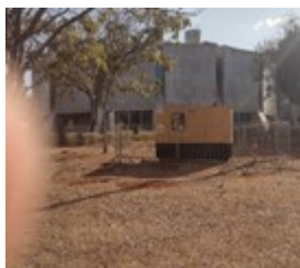
Figura 11. Utilização de geradores com uso de diesel, sendo menos poluente.
