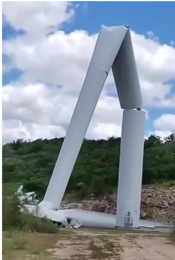
Figura 13 - Torre eólica colapsada no Complexo Eólico Ventos de São Clemente em 12/03/2025
