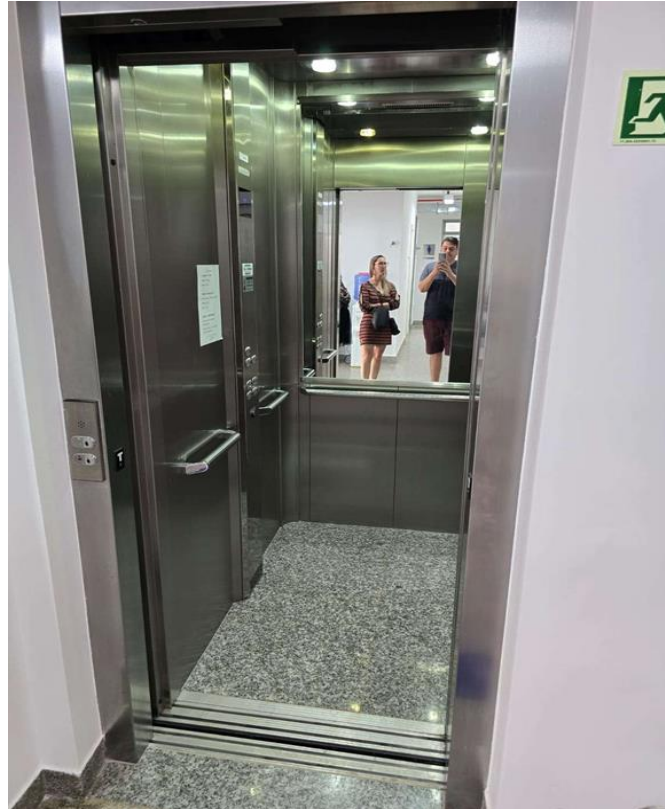
FIGURA 10. PARTE INTERNA DOS ELEVADORES
