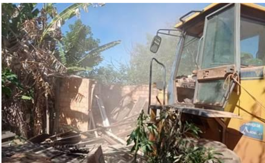
Fig.10: Derrubadas na Vargem da Benção, Recanto das Emas.
