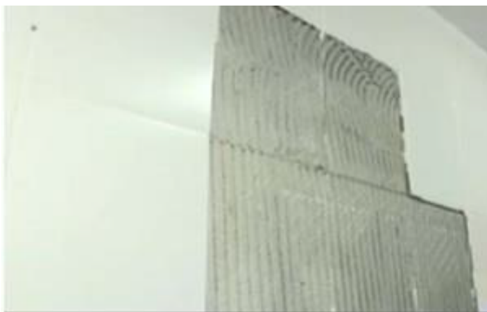
Fig. 2 - Desplacamento cerâmico em uma unidade habitacional do Residencial Parque do Riacho, localizado no Riacho Fundo II, Distrito Federal, 2018
