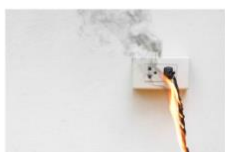
Riscos em instalações e serviços com eletricidade
