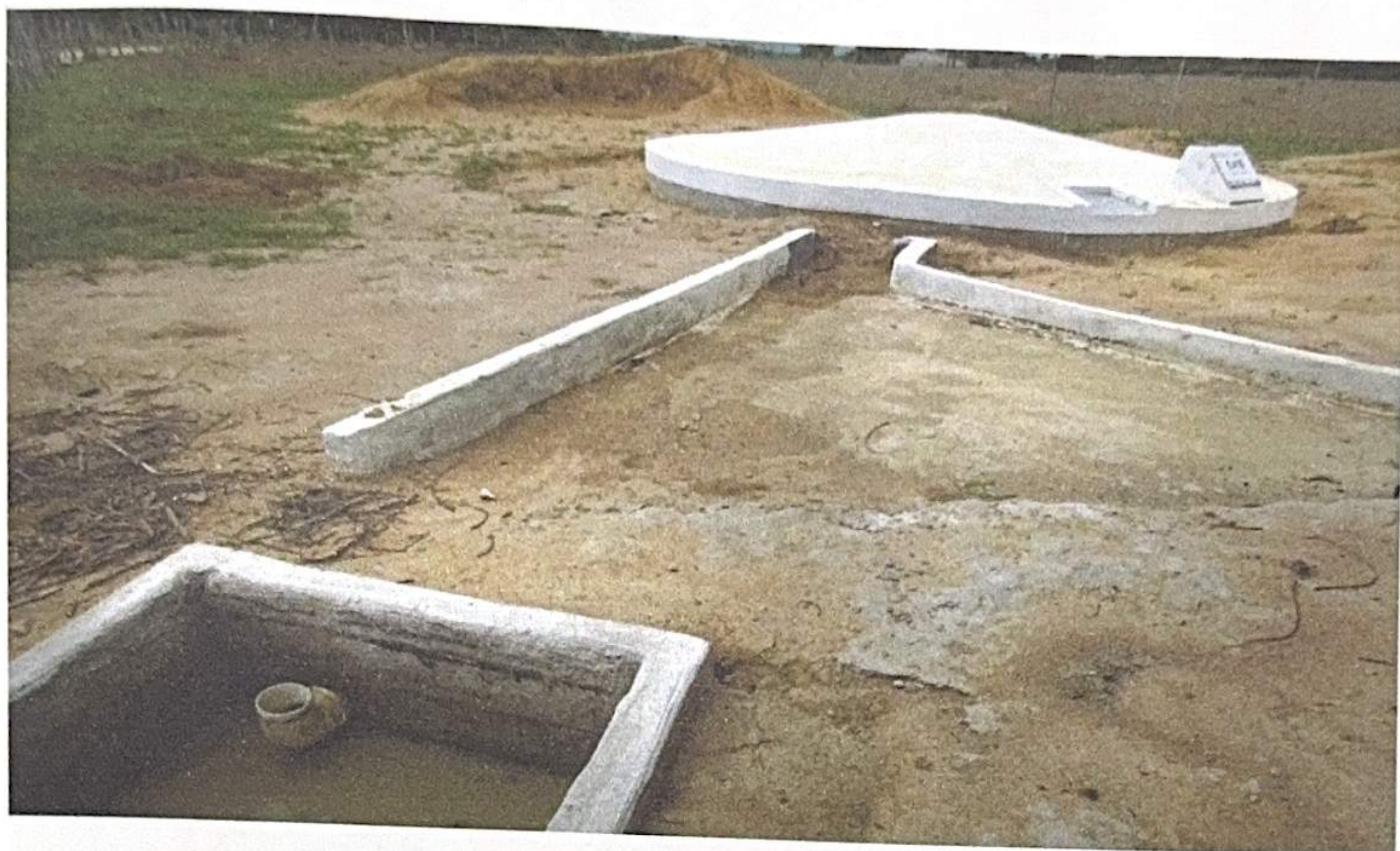
Foto 11: Problema no decantador
