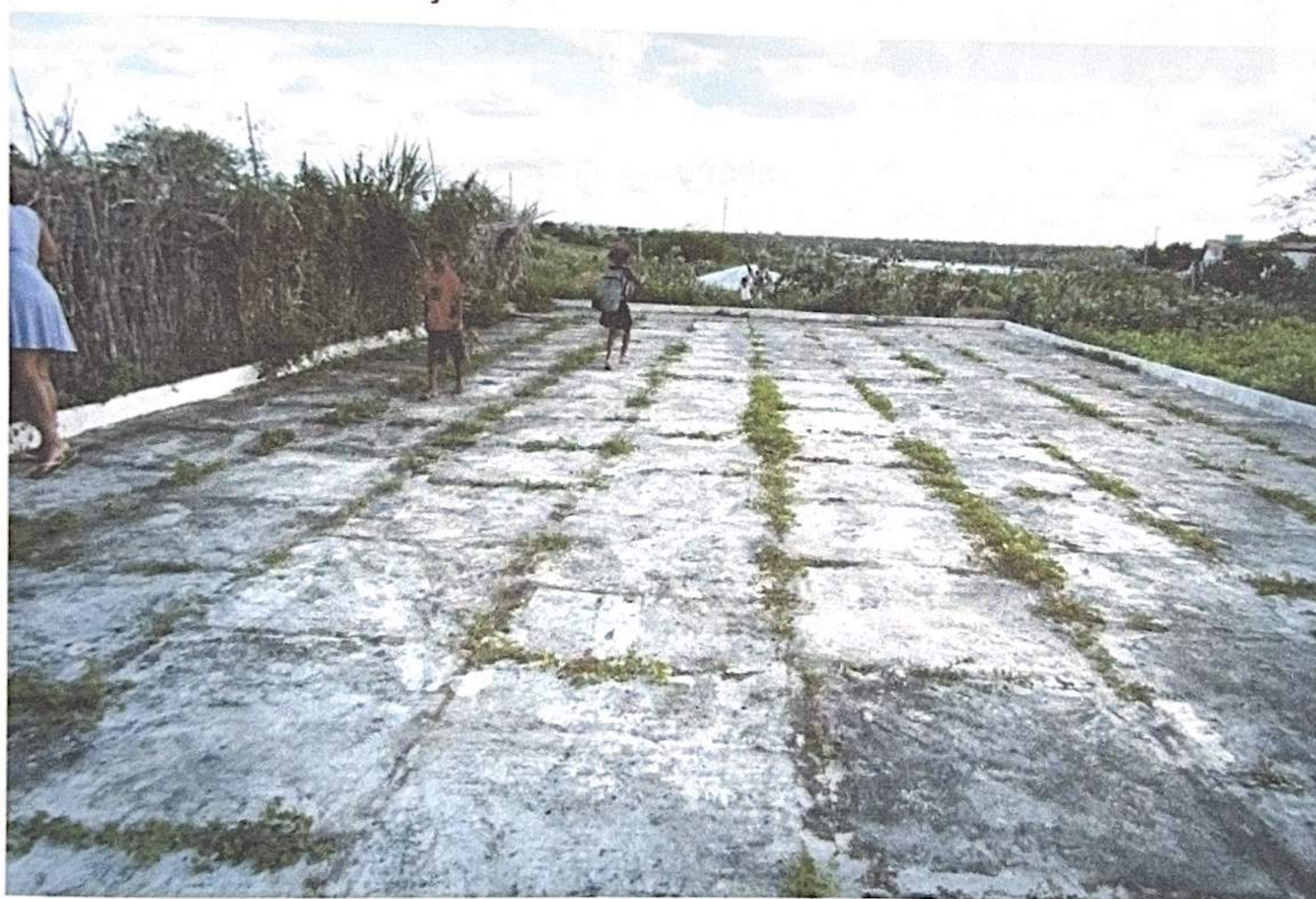
Foto 6: Rachaduras no calçadão
