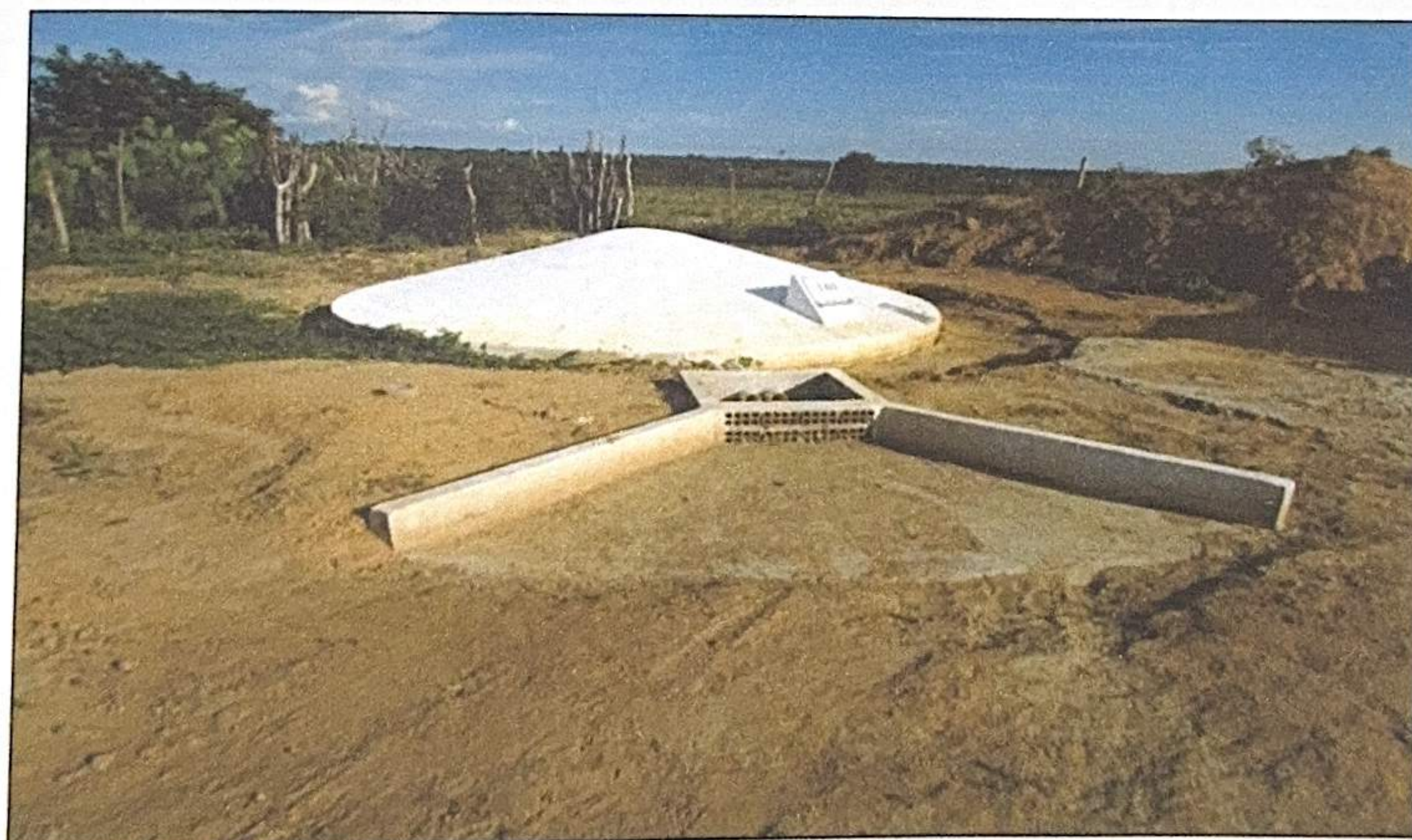
Foto 8: Problema de nível
