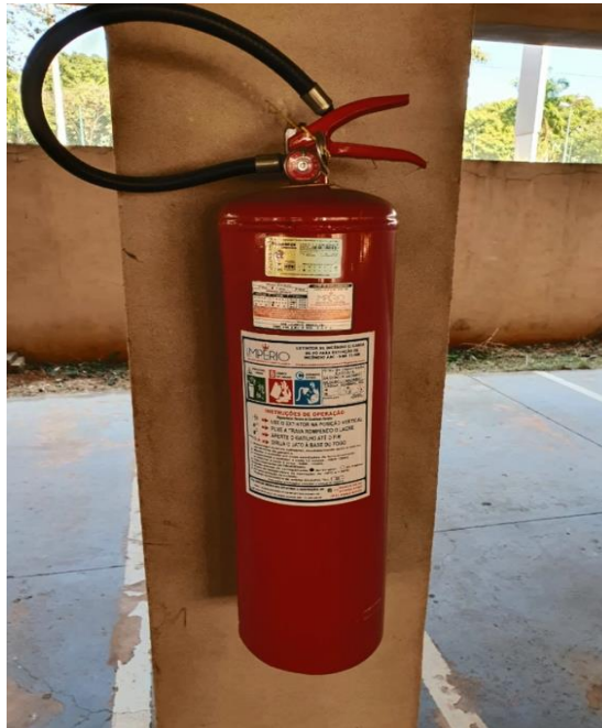
Figura 24: Extintor Localizado pelo campus
