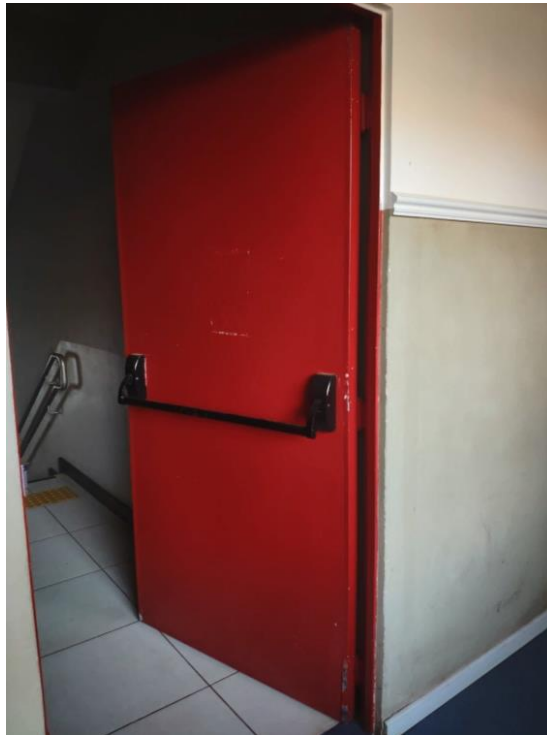
Figura 22: Porta corta fogo.
