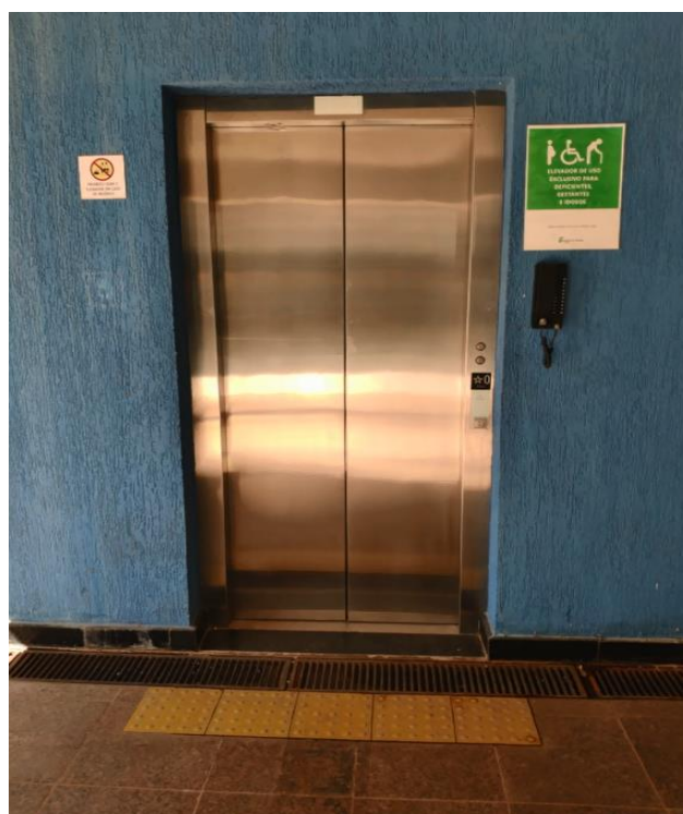
Figura 10: Elevador Interno do IFB, uso exclusivo para pessoas com deficiência ou mobilidade reduzida
