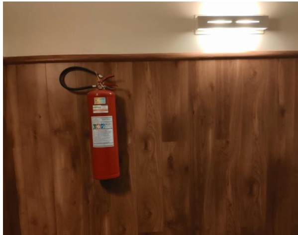
Figura 16: Extintor de incêndio localizado dentro do auditório.
